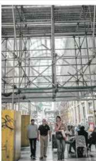
Il crollo del rosone di Galleria. In alto: il teste Bennice-Morì, che si è salvato dal crollo del rosone di Galleria, parla il sopravvissuto. Ormai convivente con i sensi di colpa.
