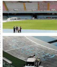
I lavori in corso allo stadio San Paolo: pista d' atletica, smontaggio dei sediolini e nuovi sediolini pronti
